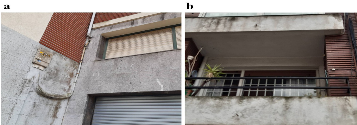
Figura 1. Presencia de hollín de partículas contaminantes en fachadas de edificios de barrios de Bilbao. a. hollín adherido a fachada y persiana de vivienda de primer piso. Obsérvese la mayor limpieza de la fachada en la parte izquierda, y la mayor presencia de hollín en las partes adyacentes a la instalación eléctrica, que no se han limpiado con la manguera. Esa zona de la fachada sería más representativa de la polución acumulada en el aire a más largo plazo. b. hollín adherido a las balconadas de viviendas de primer y segundo piso, en bloques adyacentes a una calle con circulación de vehículos. Fuente: Propia
